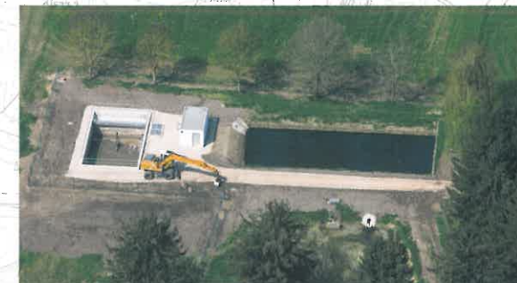
Luftaufnahme Pumpstation und Regenüberlaufbecken
